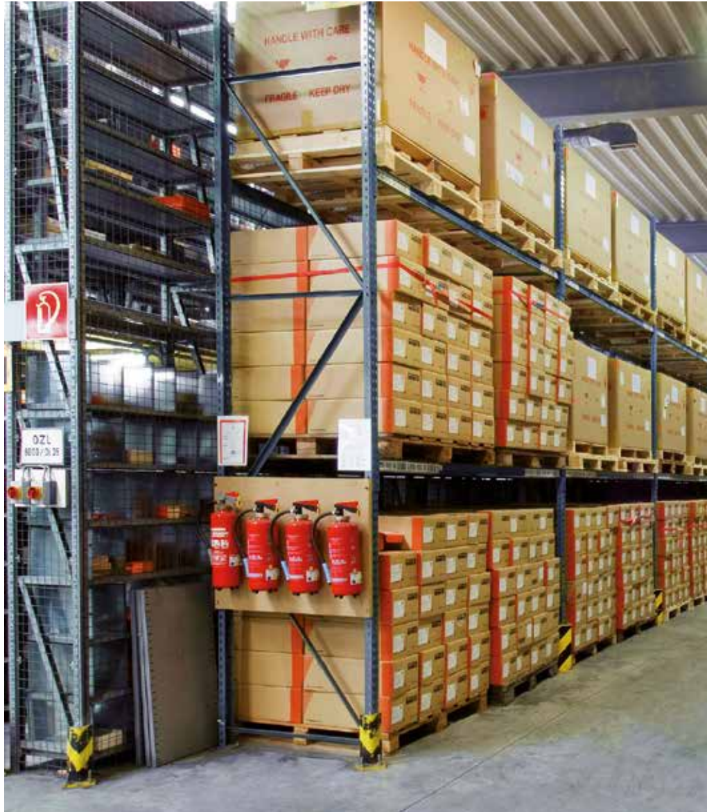
Diese Feuerlöcher müssen von befähigten Personen bzw. Sachkundigen geprüft und instandgehalten werden.
